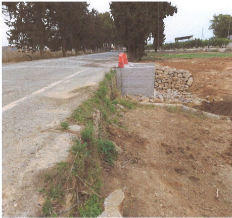
Desnivel evacuación de pluviales
