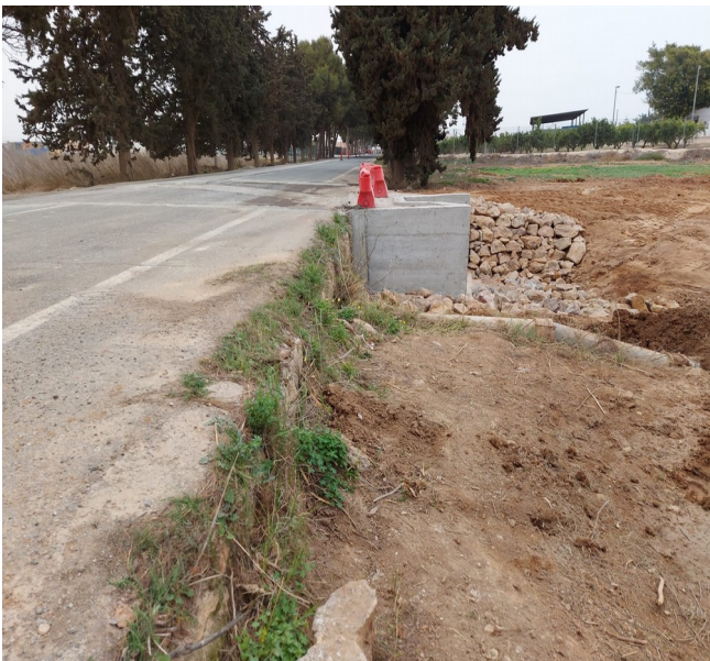
Desnivel evacuaci3n de pluviales
